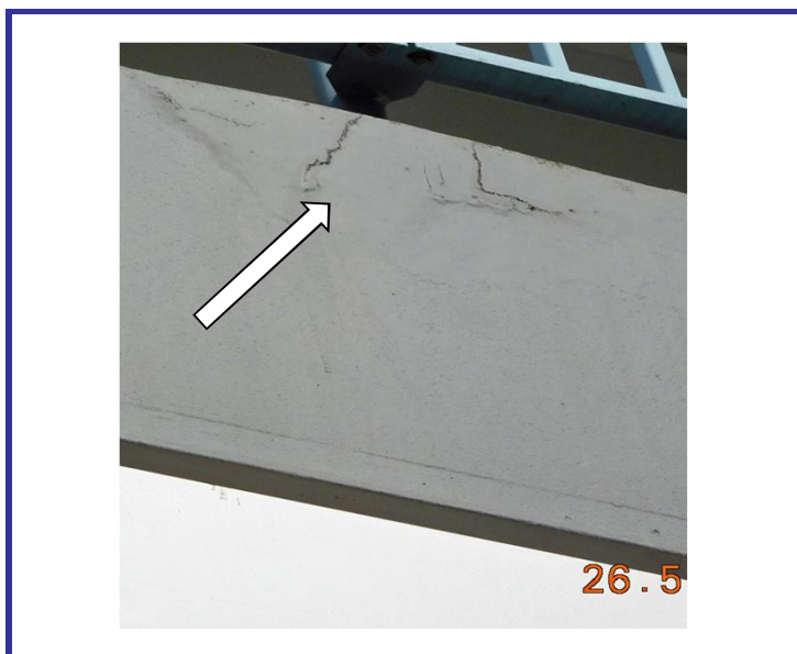
zijgevel betonconstructie; hier en daar betonrot aanwezig
